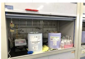
• 抽氣櫃無法有效抽風
